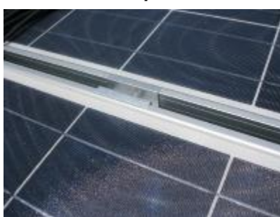
Milieu du champ PV entre modules
